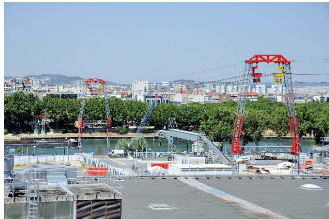
Figure 17 : La ZAC de Clichy (93) évacue les déblais du chantier à l'aide d'un téléphérique allant jusqu'à la Seine (source : VNF)
