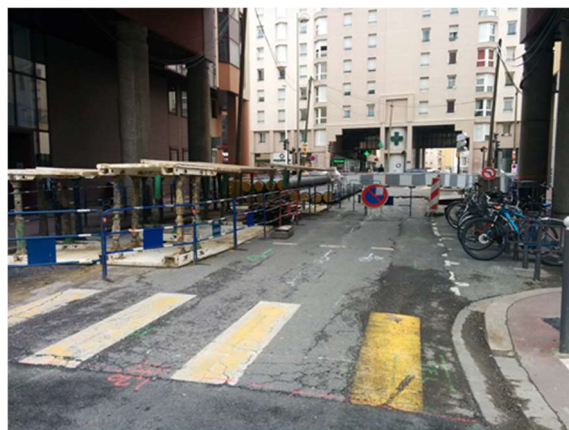
Exemple d'une voirie utilisée pour stocker du matériel et des matériaux de chantier. L'accès est fermé à la circulation et vient perturber le fonctionnement du quartier. Source : Jonction
